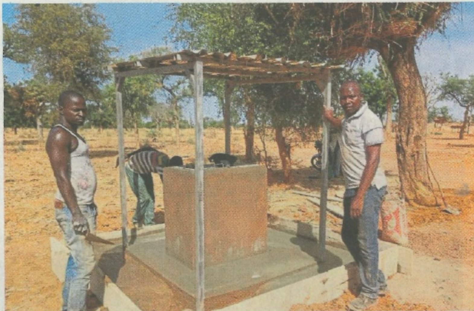
Soll bald in Betrieb gehen: einer der neuen Trinkwasserbrunnen.
